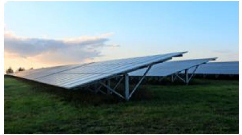
Solch eine Photovoltaikanlage soll zukünftig auch im Ortsteil Kurzlipsdorf stehen.
