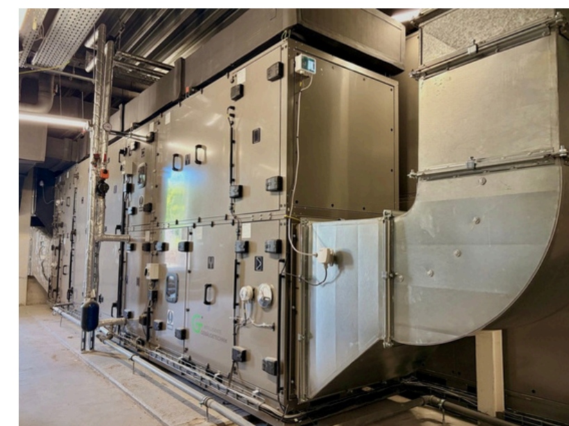
Foto: Teilansicht der Lüftungsanlage
